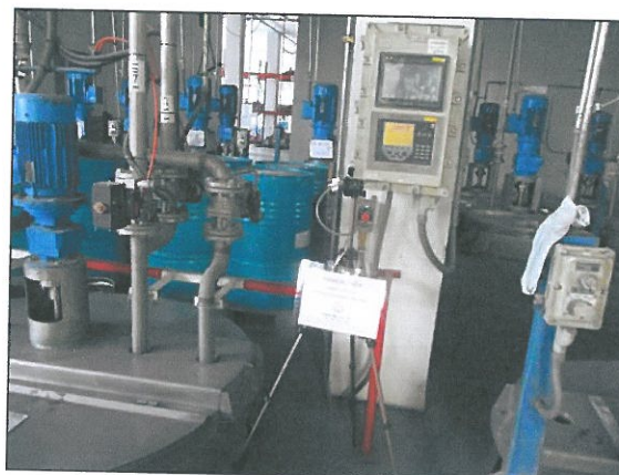
อาคารผลิต ชั้น 2 : แผนกทินเนอร์ ตรวจวัด Methanol และ Toluene
