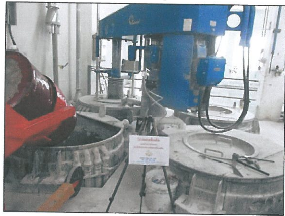
อาคารผลิต ชั้น 2 : แผนกโหลดสี-ฝั่งสีน้ำมัน ตรวจวัด Total Dust และ Xylene
